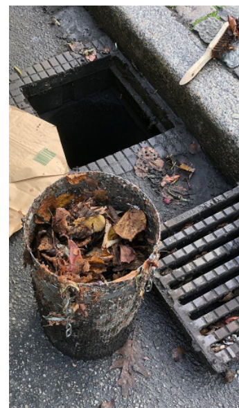
Brunnskorg fylld med löv. Foto Malmö stad
