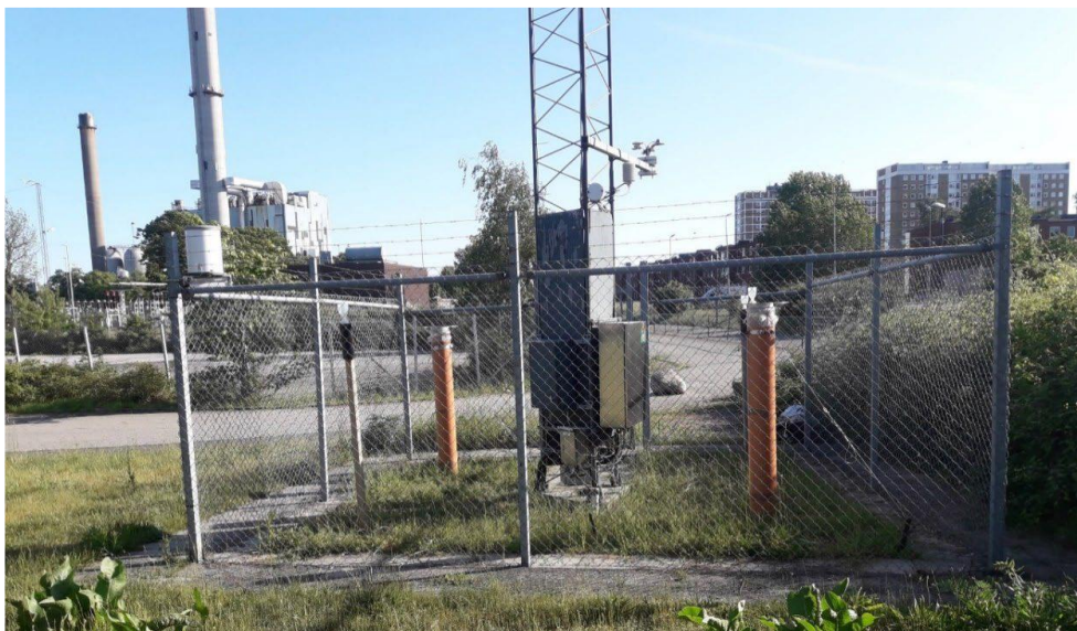
Figur 33. Foto på mätutrustning vid den meteorologiska mätstationen i Heleneholm, Malmö.
